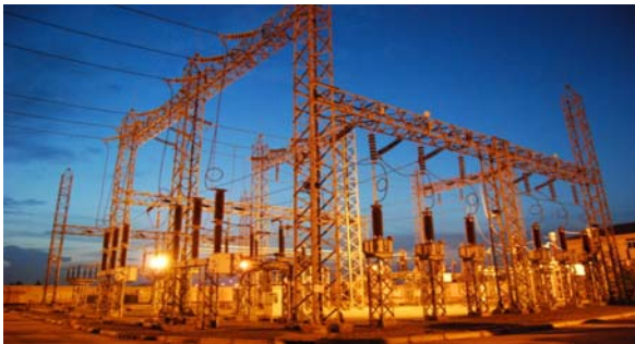
TRẠM BIẾN ÁP 110KV PHÚ MỸ HƯNG
