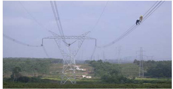
ĐƯỜNG DÂY 500 KV ĐÀ NẴNG – HÀ TĨNH
