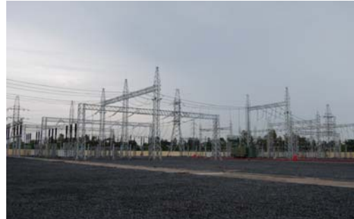
TRẠM BIẾN ÁP 220KV CAO LÃNH
